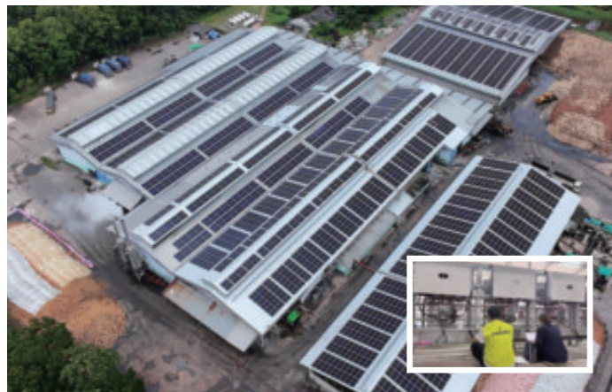
| 泰国甲米橡胶厂光伏项目 2MW
