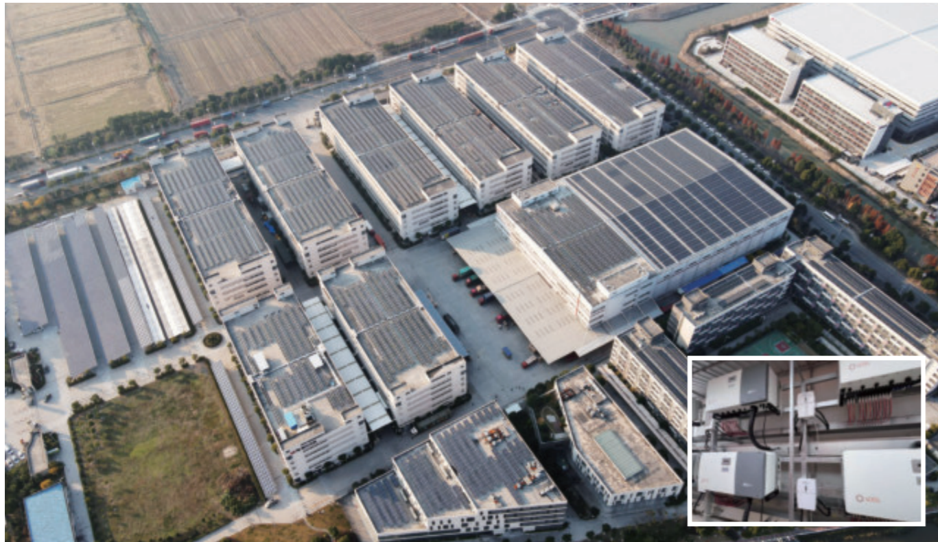
| 上海晨光文具光伏项目 5.5MW
