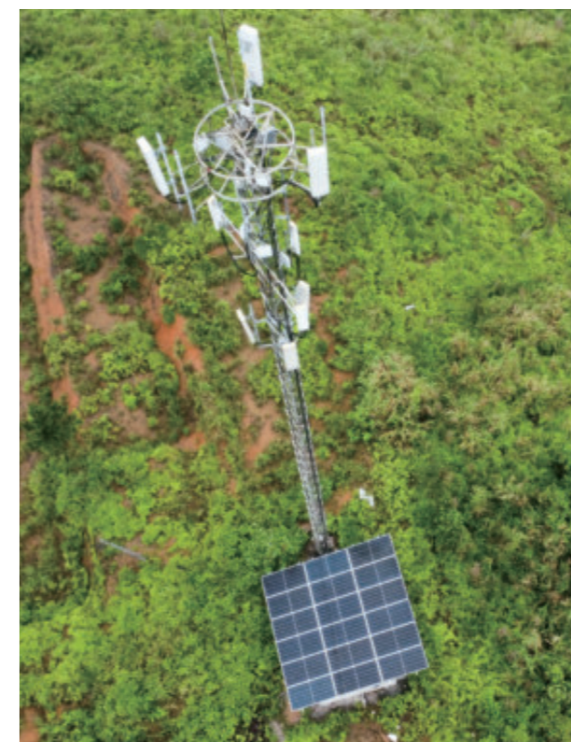
| 江西铁塔光伏项目 12kW
