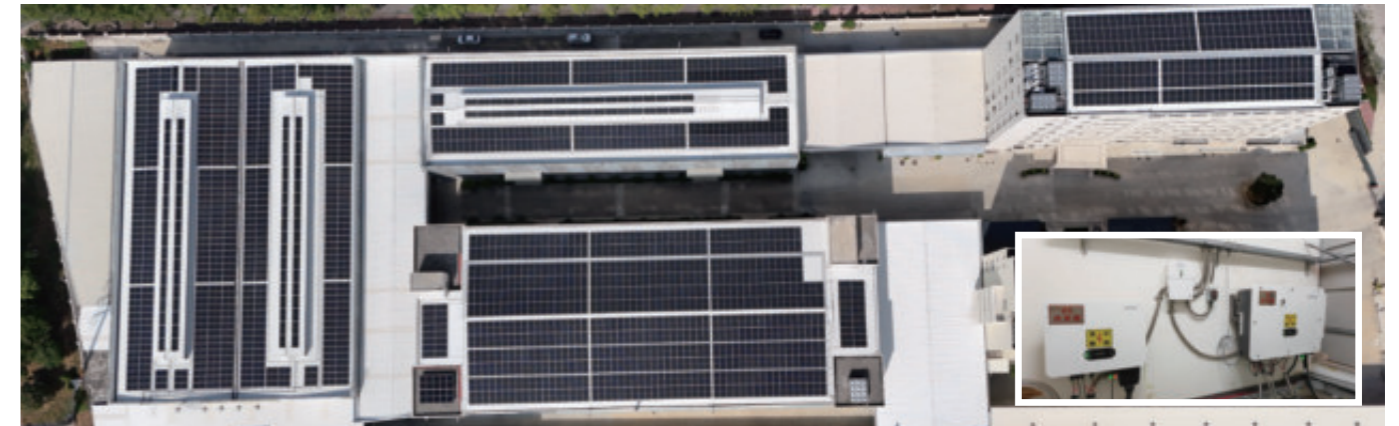
| 福建南鑫电子厂光伏项目 1066.83kW
