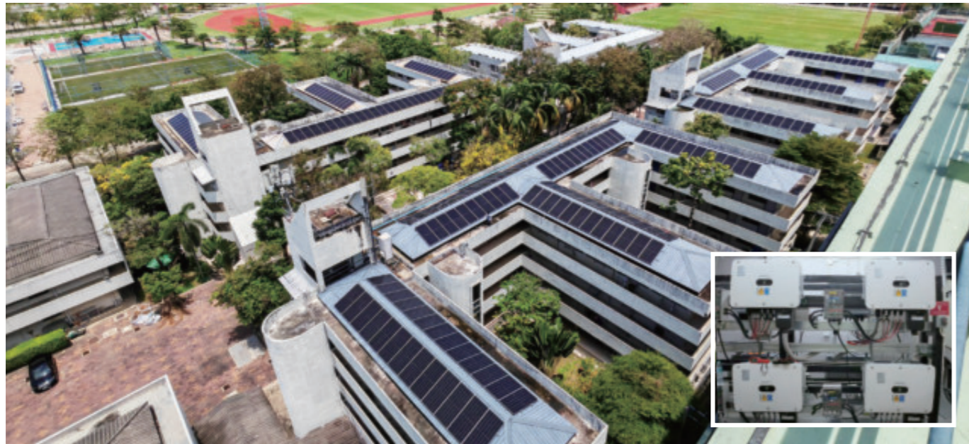
| 泰国曼谷先皇理工大学光伏项目 6.5MW
