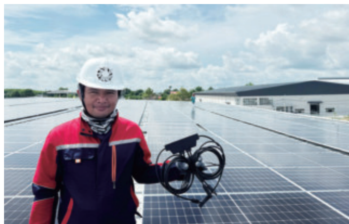
| 泰国罗勇五金制造厂光伏项目 400kW
