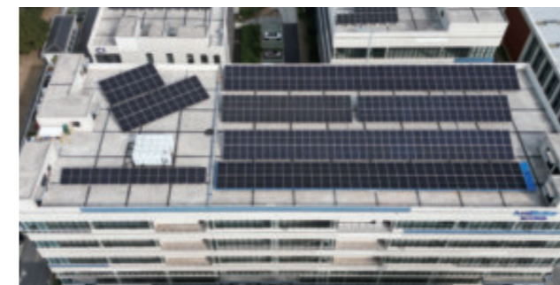
| 江苏3E产业园光伏项目 204kW
